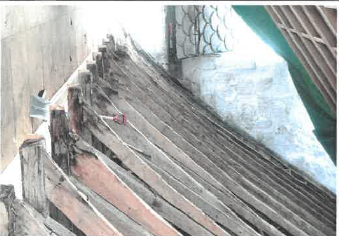
Takfoten på begge sider av kortaket, var i praksis store sammenhengende skadesoner. Her er undertaket åpnet og demontert i sin helhet.
